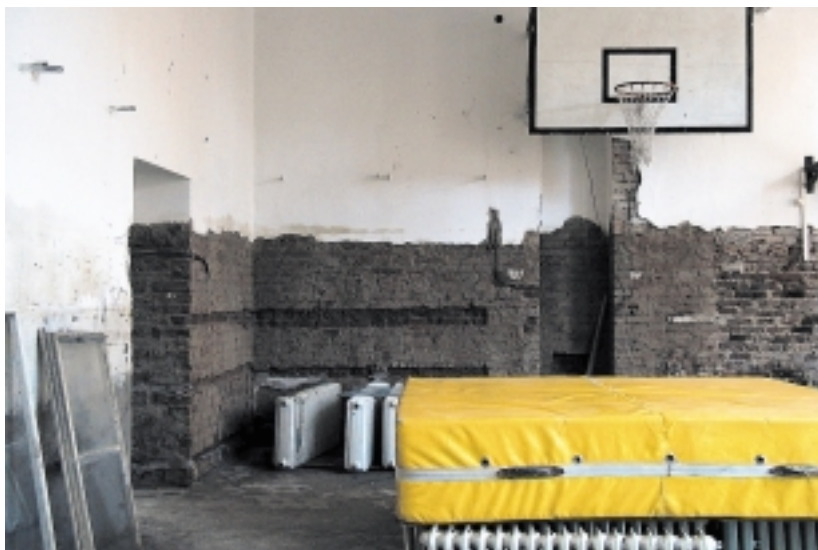
Zničená tělocvična v přízemí školy, stejně byla zničena jídelna a školní knihovna
