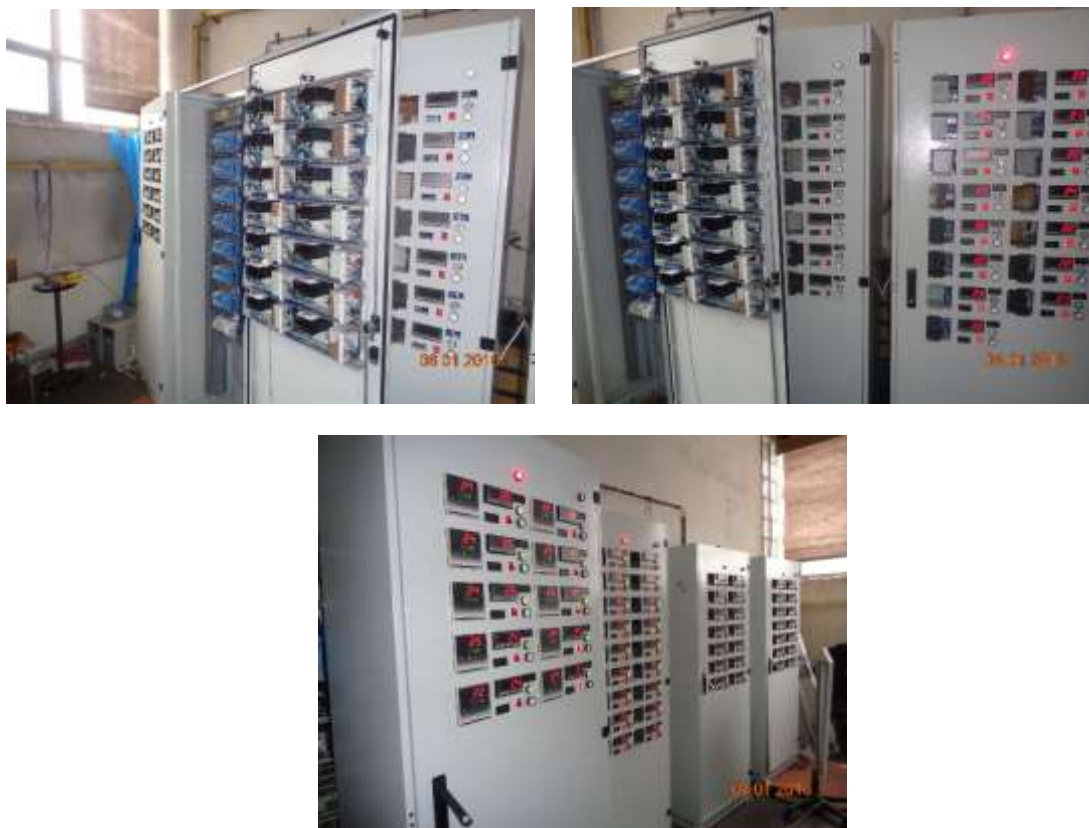
Skříně nového systému řízení
