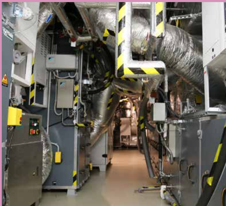
Klimatizace v Centrálním depozitáři v Litoměřicích
