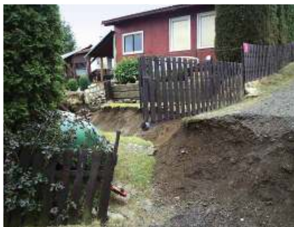
■ Sesuvná trhlina pod rekreačním objektem.
