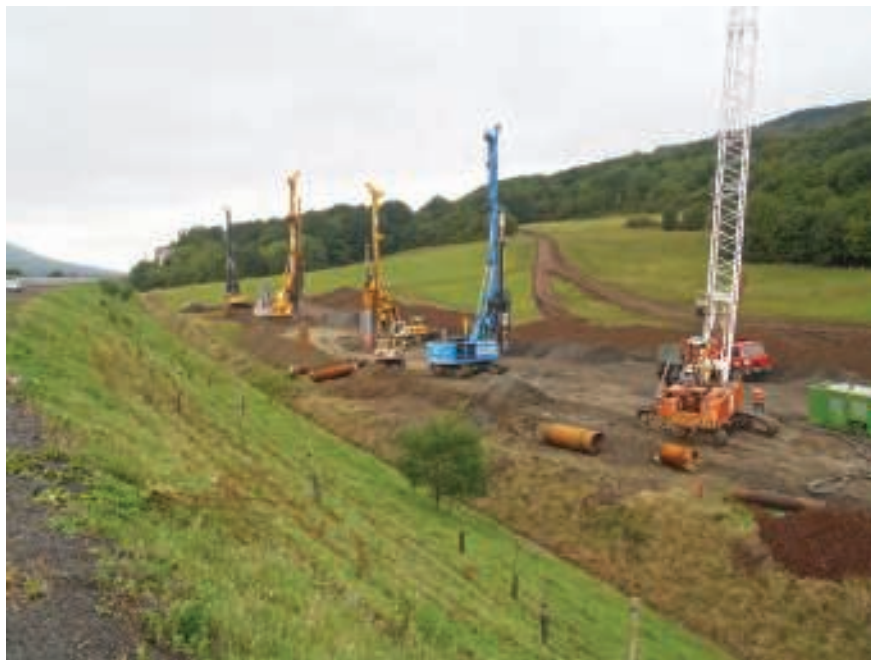
Dálnice D8 (km 57,400). Realizace podzemní štěrkové stěny podél náspu pomocí pilotů vrtačných do hloubky 16 m. Foto P. Kycl.
