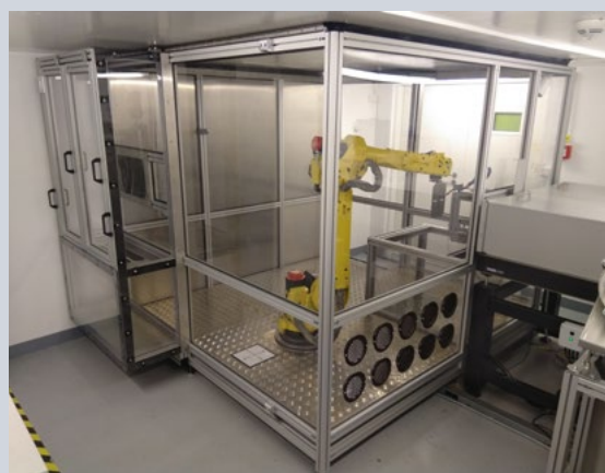
Obr. 124 Bezpečnostní buňka uvnitř LSP stanice.
