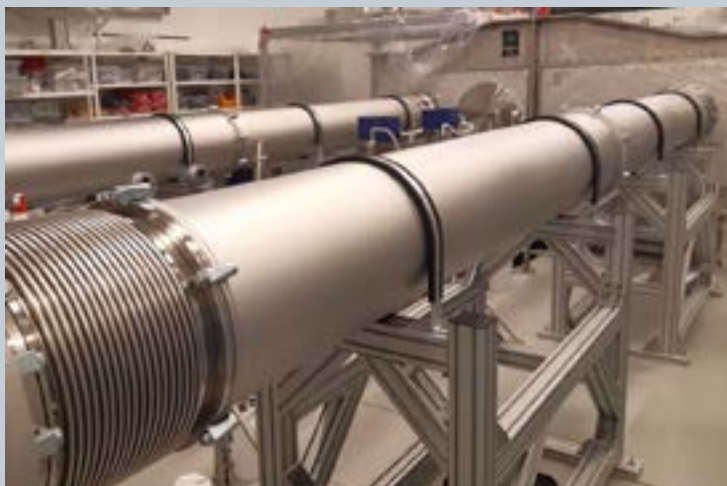
Obr. 2.6.28: Vakuové potrubí transportu laserového svazku L3 v hale E5
